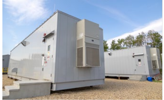
Figure 7 : Systèmes de distribution d'énergie et de stockage par batteries chez E.L. Smith.
