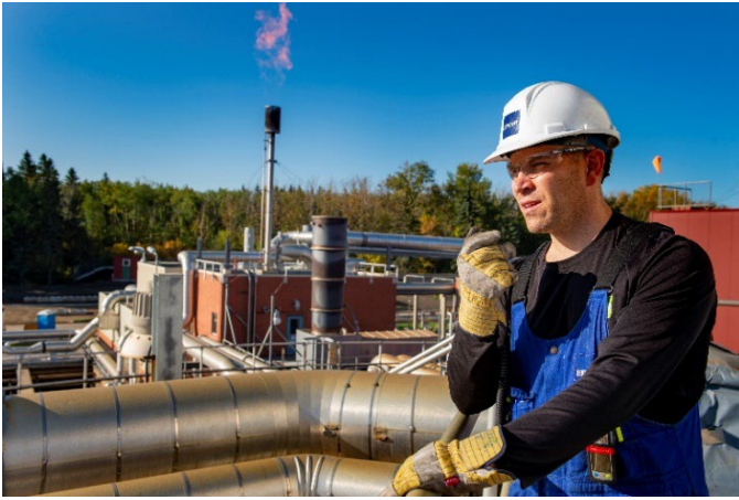
Figure 5 : Station d'épuration de Gold Bar, avec torchage de biogaz visible.
